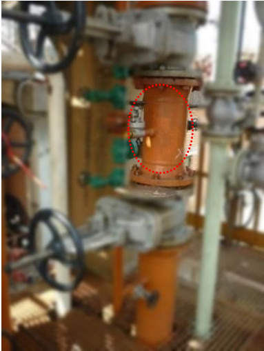
Figura 25. Gas combustible a la línea de GLP vaporizado
