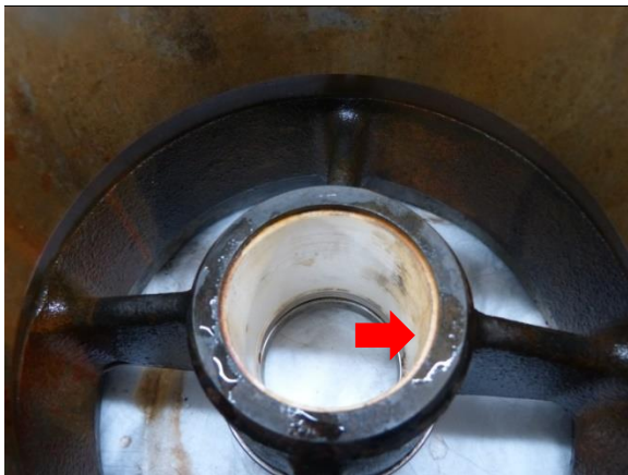
Figura 39 Base bomba. Desgaste severo en bushing de estabilización
