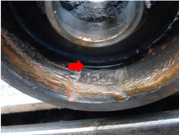
Figura 51 Impeller, corrosión severa sobre las áreas de empuje ascendente.
