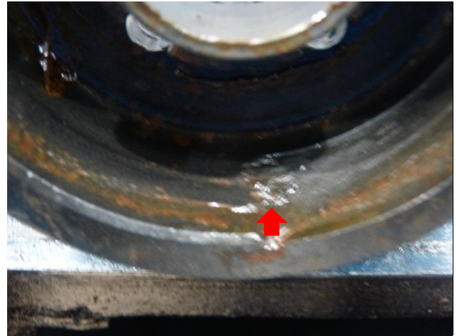
Figura 53 Impulsores presentaron focos de corrosión generalizada.
