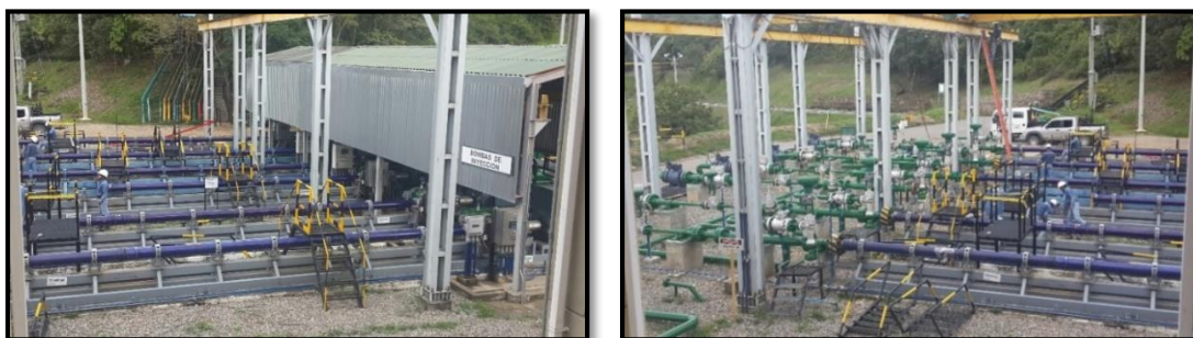
Figura 35 Estación de bombeo
