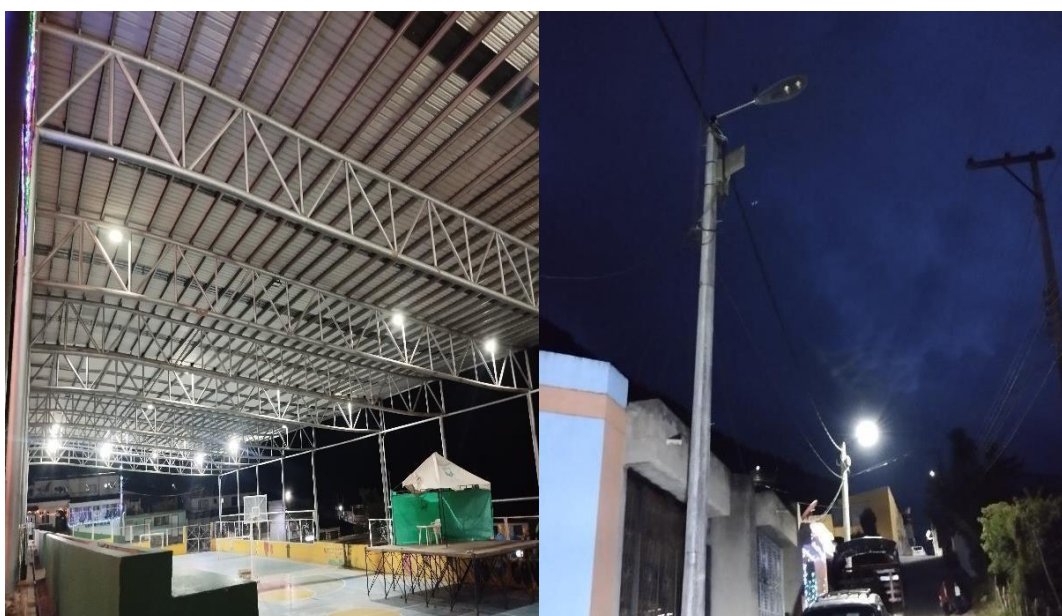
Alumbrado público polideportivo y de la carrera 2
