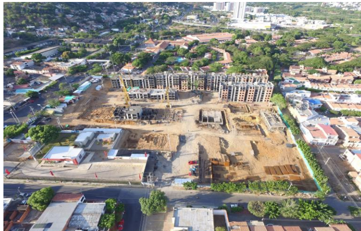
Figura 4. Proyectos de vivienda de la ciudad de Cúcuta en etapa de construcción
