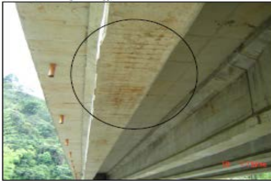
Figura 8. Evidencia de manchas de óxido en la superficie del concreto. (Puente sobre el Río Quindío, 2005)
