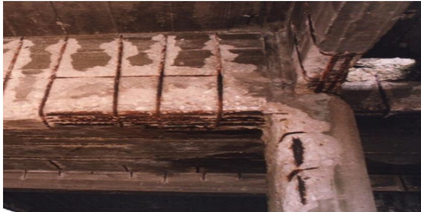
Figura 13. Aspecto de la superficie de un concreto lixiviado.
