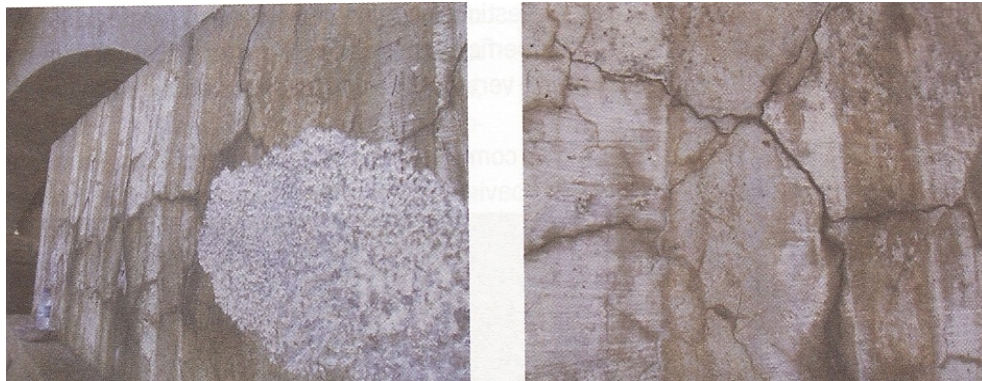
Figura 12. Estructura del Puesto Paulo Guerra afectada por reacción álcali-sílice.
