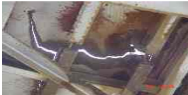
Figura 6. Problemas de corrosión y falla estructural. Puente el Limón (Meta).
