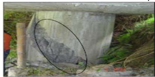
Figura 25. Fisuración por Torsión de una pila.
