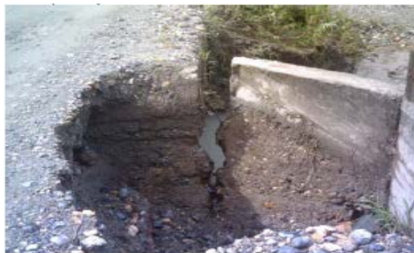
Figura 3. Volcamiento de una aleta. (Puente Pacamí, Choco, 2006).
