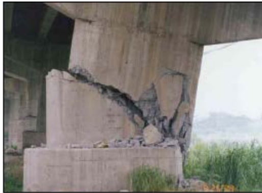
Figura 21. Fractura por cortante en la Pila ( Puente U Shi. – Taiwan, 1999 ).
