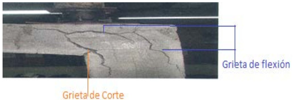
Figura 5. Grietas de Flexión (a), (b) y corte (c).
