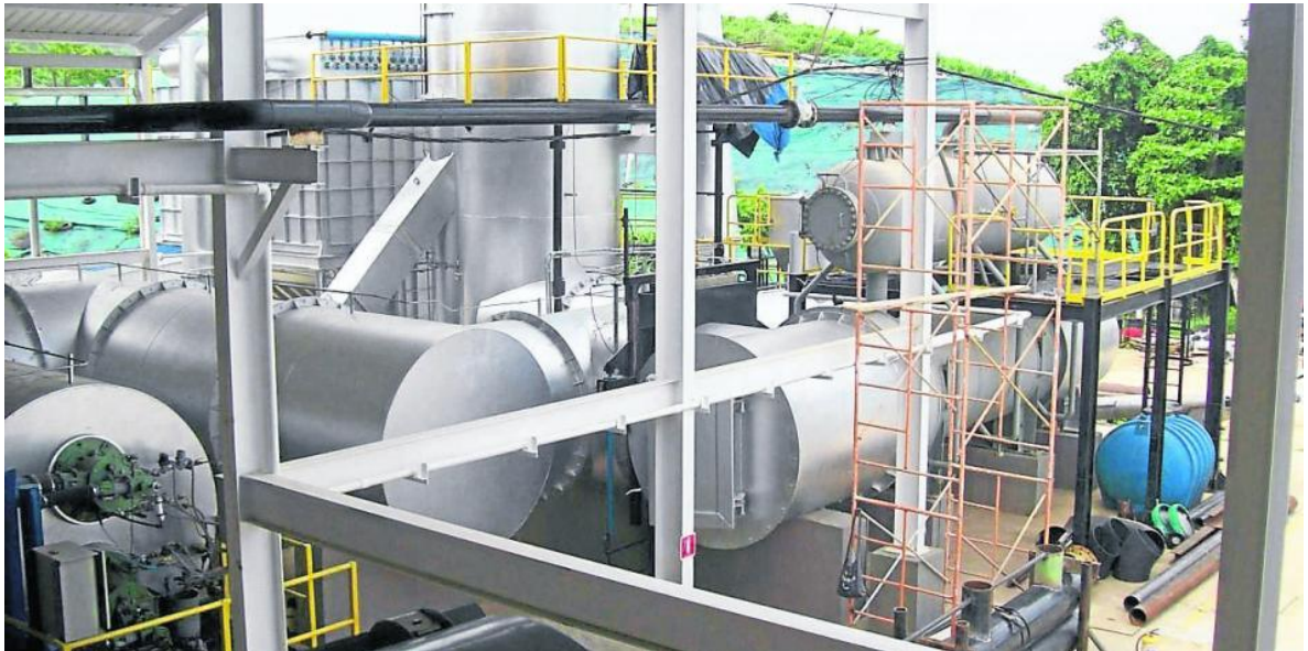
Figura 11. Planta de generación de energía eléctrica a partir de residuos sólidos urbanos en san Andrés
