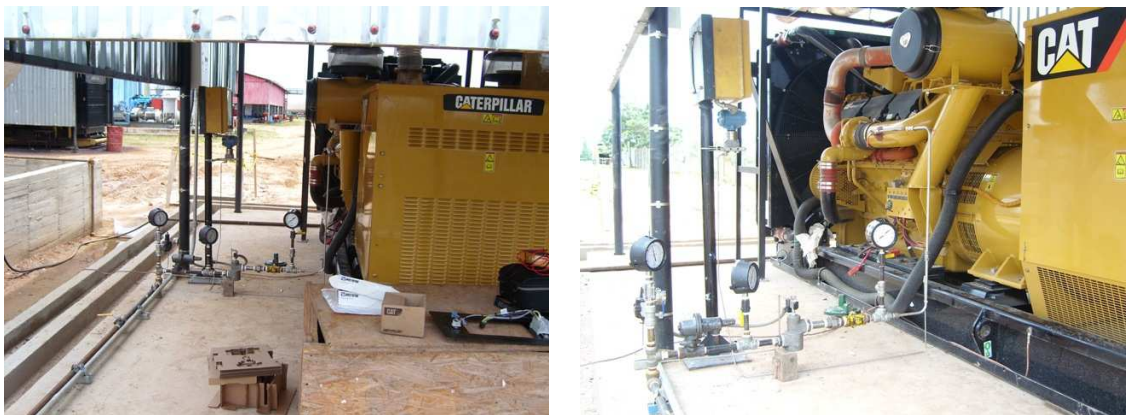
Figura 10: Fotografías de la instalación del sistema “Bi-fuel”
