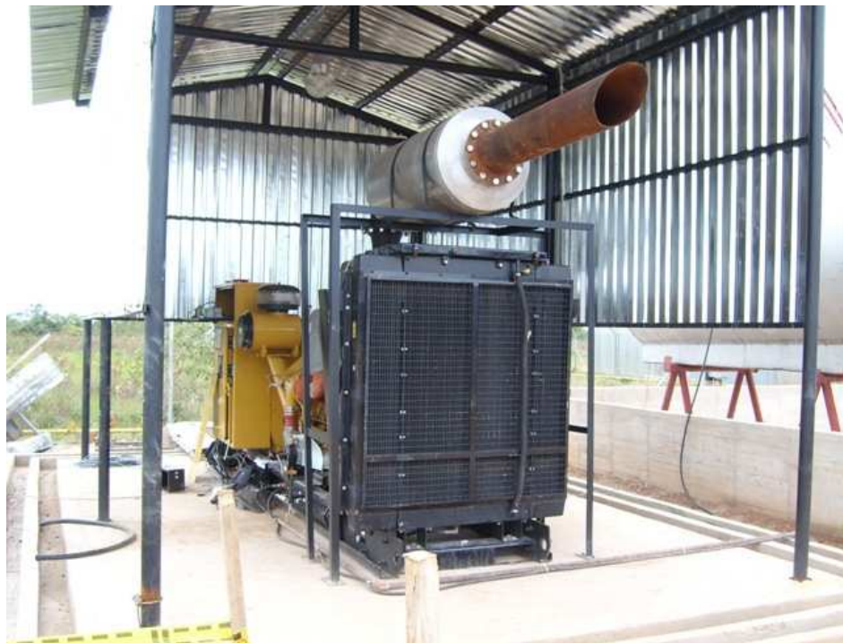
Figura 6: Grupo electrógeno C27 de la estación SAD
