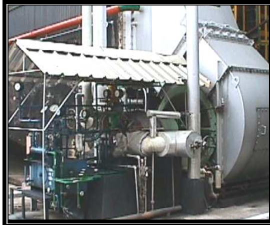
Figura 58. Ventilador de tiro forzado de una caldera
