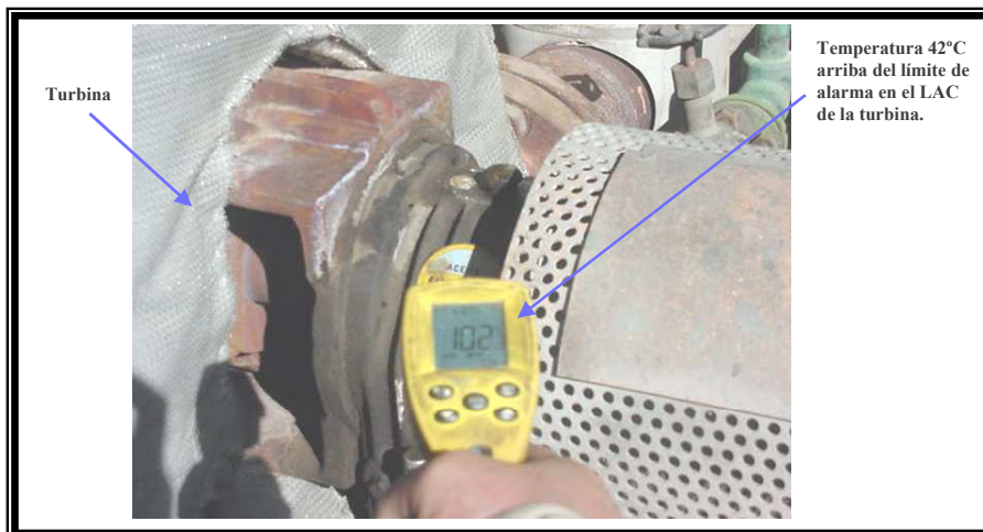
Figura No 16. Alta temperatura en el cojinete lado acople de la turbina.
