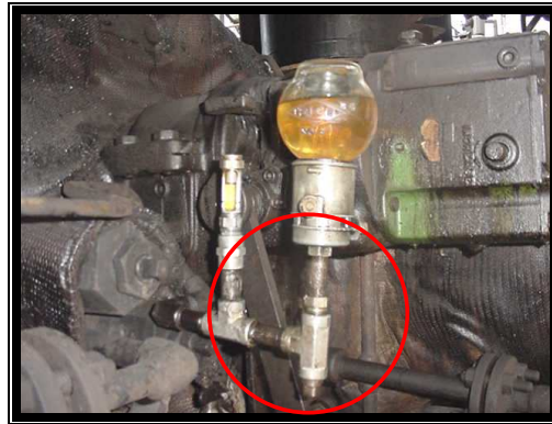
Figura 12. Montaje inapropiado del visor de nivel y la botella. No se deben conectar en la misma tubería.
