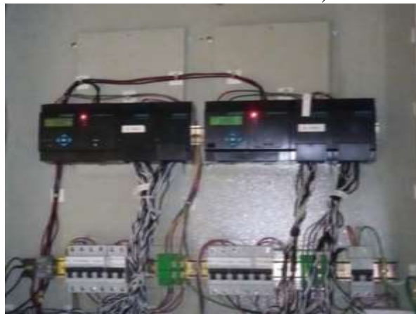
e) AcuRev 2 y 3 zona tableros.
