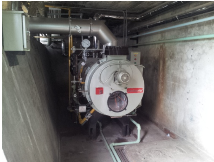
Figura 6.16: Estado Actual de la Caldera Fuente: Autores
