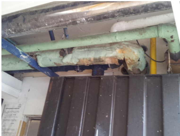
Figura 6.17: Aislamiento Térmico de la Tubería Deteriorado Fuente: Autores
