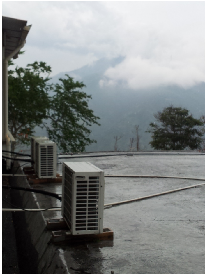
Figura 6.11: Aires Acondicionados a la intemperie Fuente: Autores
