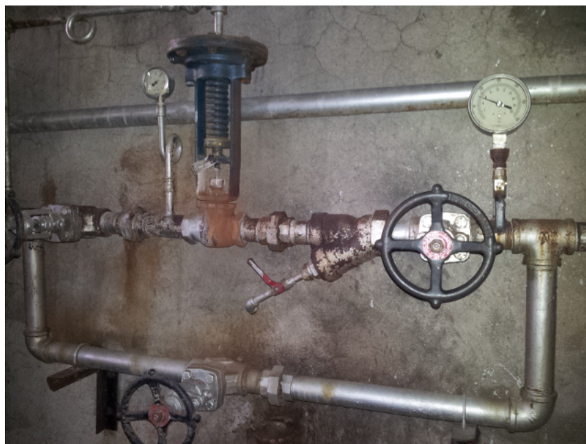
Figura 6.15: Estado de la Tubería de Vapor Fuente: Autores
