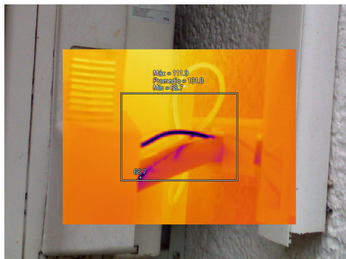
Figura 6.13: Deterioro del Aislante del Aire Acondicionado Fuente: Autores
