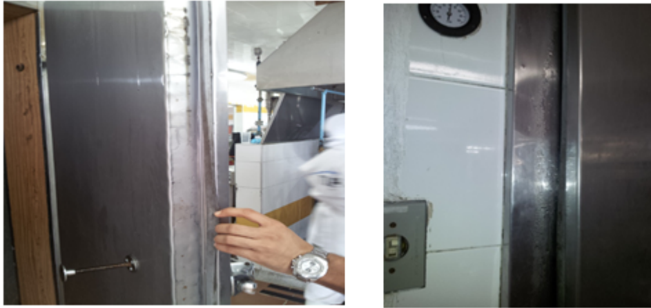
Figura 6.7: Deterioro del Aislante de las puertas de los cuartos Fríos Fuente: Autores
