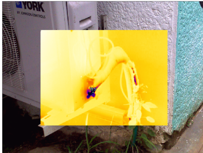
Figura 6.12: Deterioro del Aislante del Aire Acondicionado Fuente: Autores
