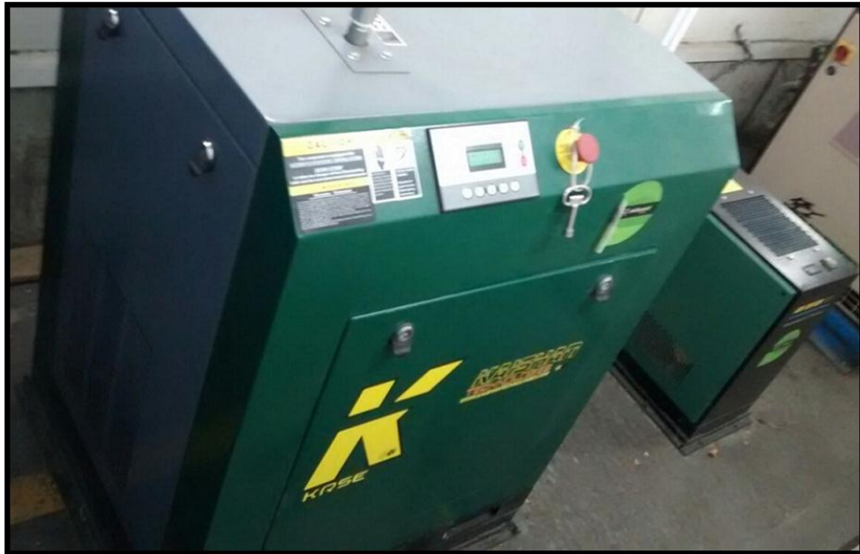
Figura 3. Compresor + Secador de instrumentos marca Kaishan.
