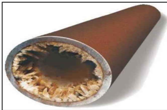
Figura 6. Acumulación de escamas dentro de una tubería de producción.
