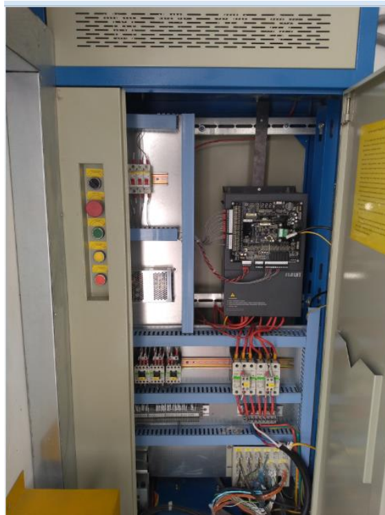
Figura 18. Tablero de control
