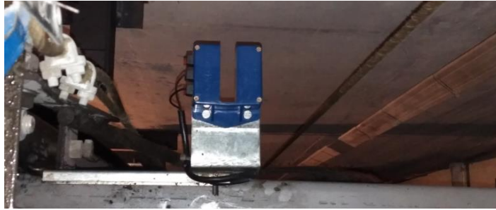
Figura 15. Sensor MR, montado en cabina
