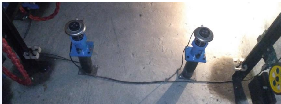
Figura 29. Amortiguadores en foso
