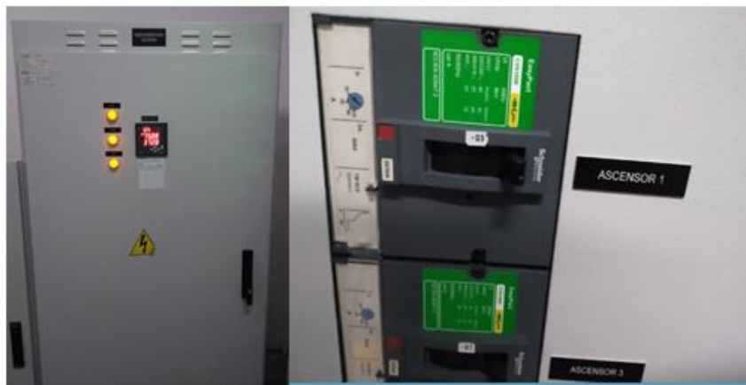
Figura 17. Tablero eléctrico principal
