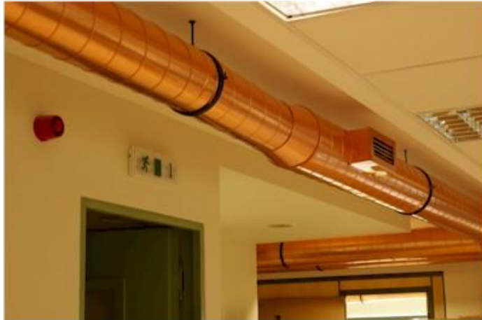
Figura 28. Ducto de Aire Acondicionado en una Piscina
