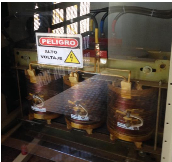
Figura 13. Transformador de Servicios
