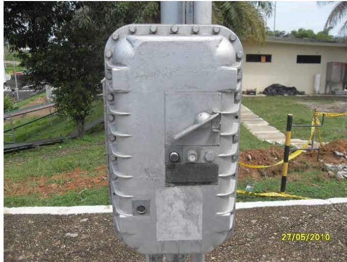
Figura 19. Control de reinicio eléctrico del transformador del TTE.
