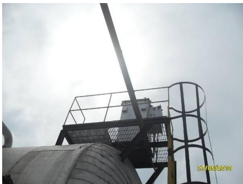
Figura 18. Transformador sección electrostática del TTE.
