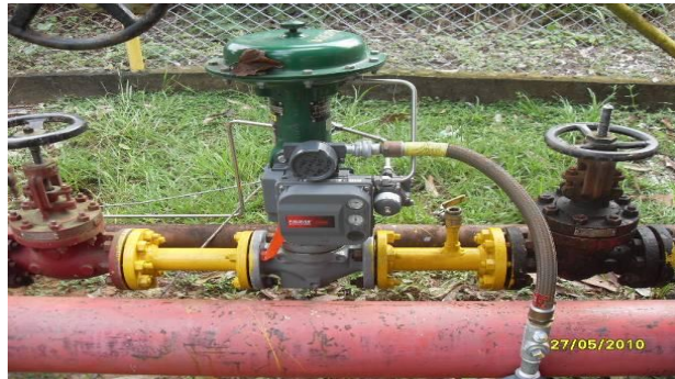
Figura 7. Válvula de control de flujo (Gas)
