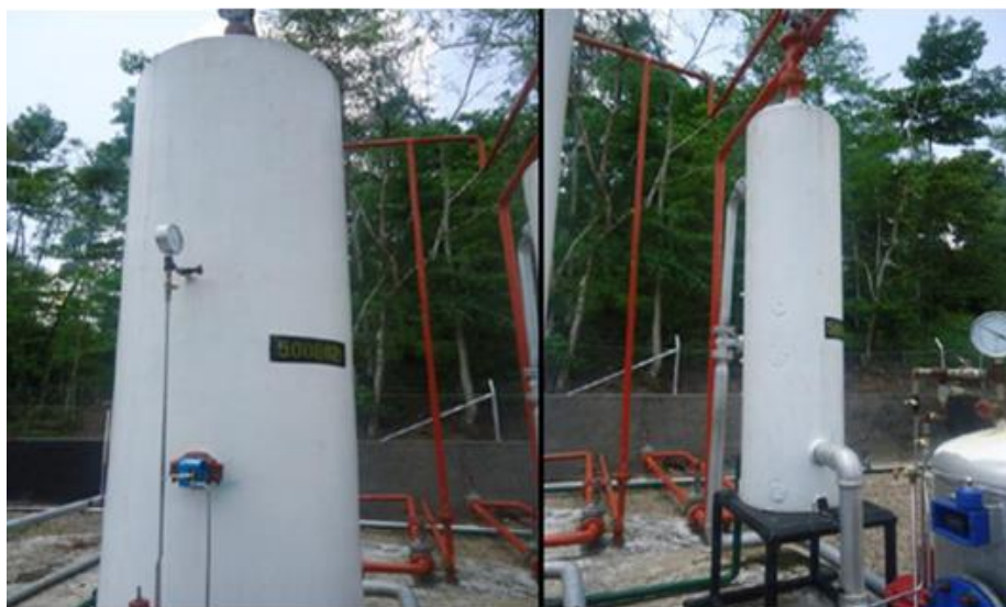
Figura 9. Separador general y de prueba
