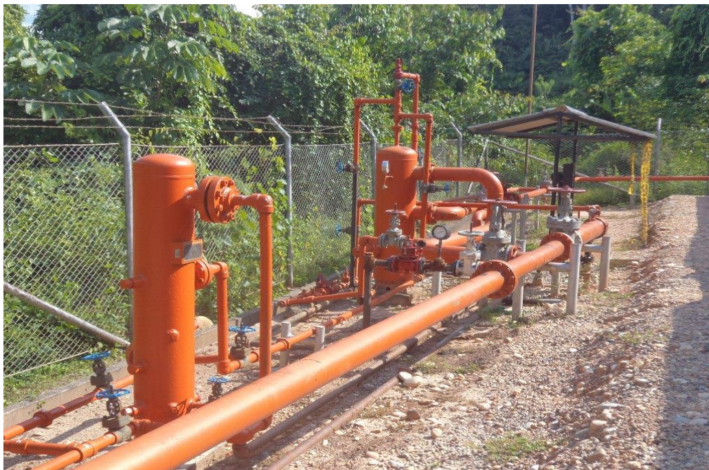
Figura 10. Líneas de gas y scrubber
