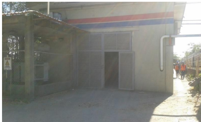
Figura 16. Cuarto Principal de Compresores
