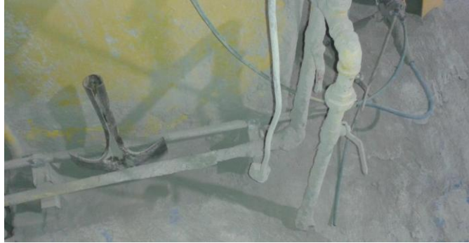
Figura 27. Tubería corroída por el cemento en el área de empaque
