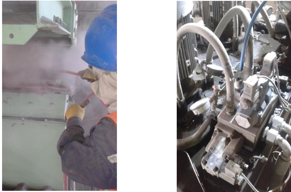
Figura 29. Usos inadecuados del aire comprimido
