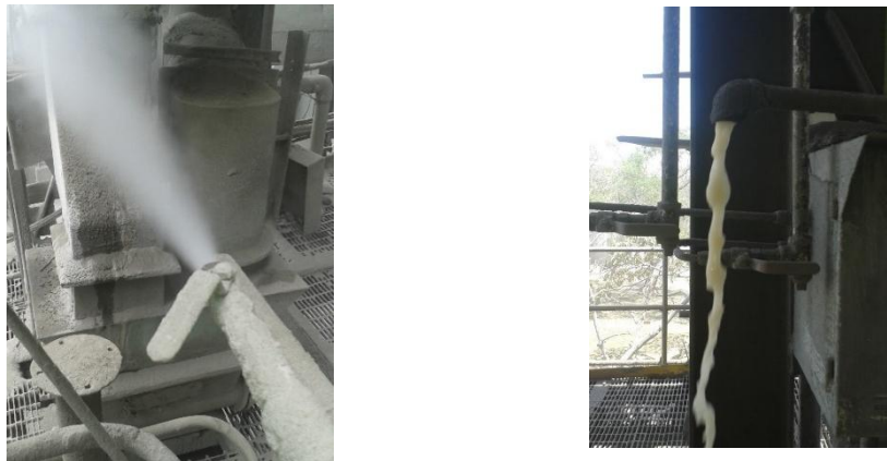
Figura 23. Aire comprimido húmedo en las líneas de consumo en el área de Molienda de Cemento.
