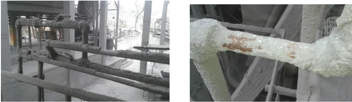
Figura 26. Tubería cubierta con material y corroída área molienda de cemento
