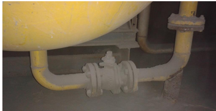
Figura 25. Conexión atípica de una línea a la salida de un tanque pulmón.
