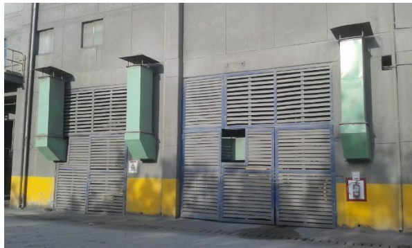
Figura 19. Cuarto de Compresores área de empaque
