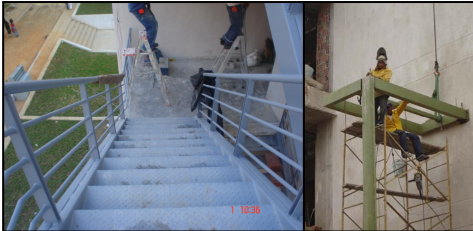
Figura 13. Escalera metálica para emergencias.
