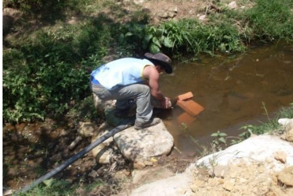
Figura N° 3 Captación de agua.
