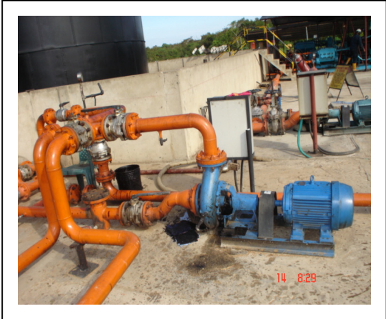
CENTRIFUGA MANIFOLD CARGADERO
