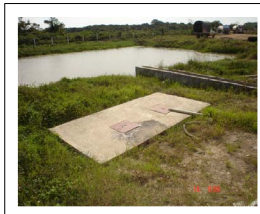
FOTO 17. CAJA DE VERTIMIENTO
