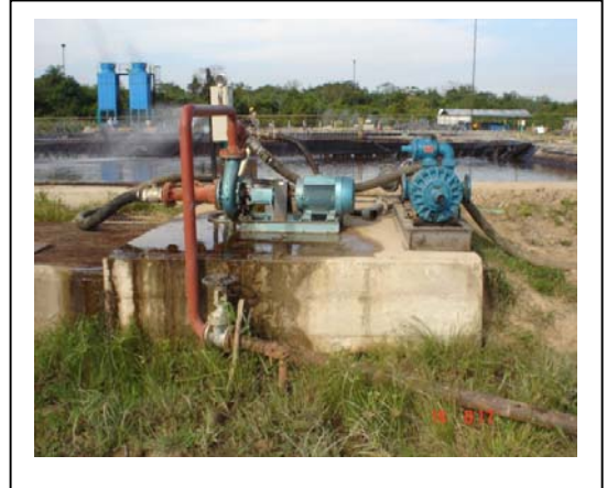
FOTO 22. BOMBAS PARA VERTIMIENTO
