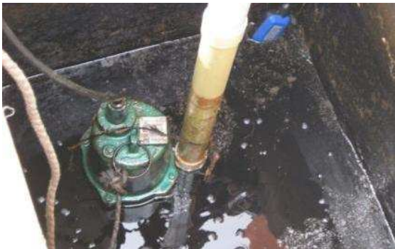
Foto 3. Bomba de tanque homogenizador PTAR
