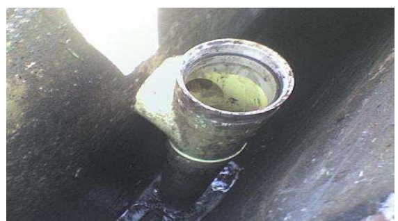
Foto 15. Tubería de conexión de cámaras a filtro anaeróbico
