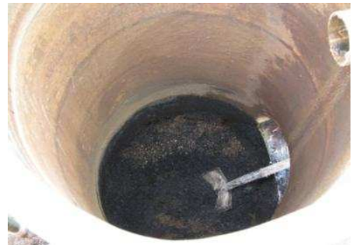
Foto 4. Filtro carbón activado PTAR
