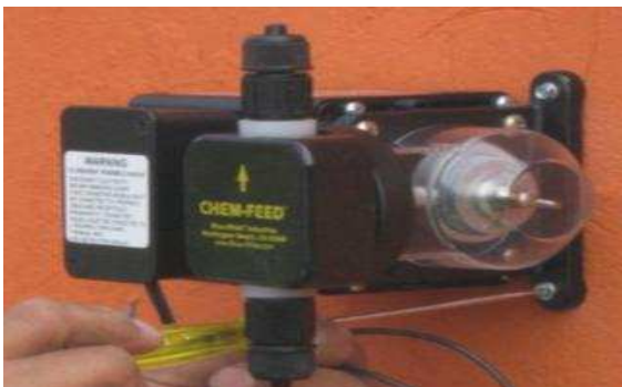
Foto 5. Bomba dosificadora hipoclorito de sodio PTAR
