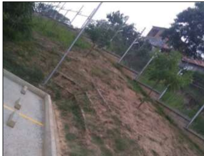
Figura 17. Talud cerca de la torre y a la cancha múltiple del conjunto residencial PUERTO VIENTO ubicada en Girón, Santander.
