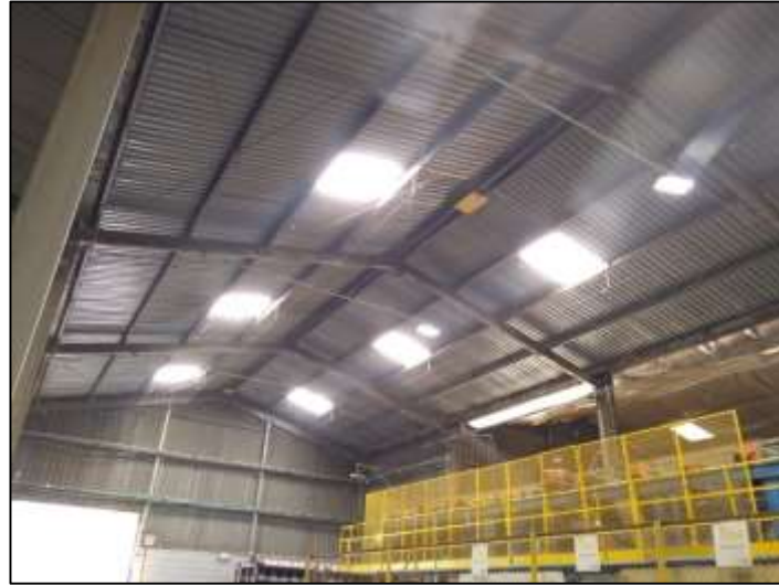
Figura 13. Lugar donde se ejecutara la instalación de láminas para cubierta en la empresa FIBERGLASS ubicada en Girón, Santander.
