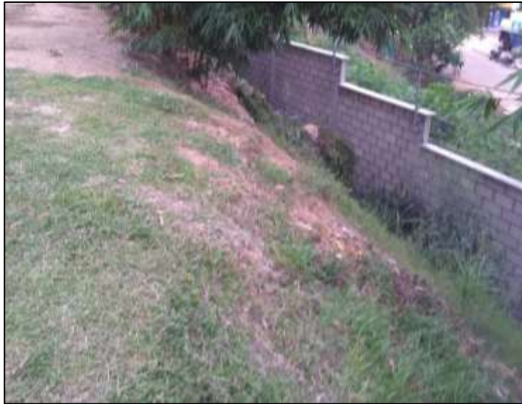
Figura 18. Talud situado en la parte perimetral occidental, aledaña a la zona social del conjunto residencial PUERTO VIENTO ubicada en Girón, Santander.
