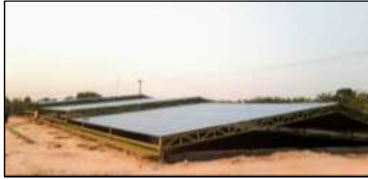
Figura 12. Resultado final del proyecto de sistema para cubierta en la empresa SOLUCINAR ubicada en Sabana de Torres, Santander.
