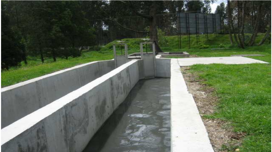
Foto 4. Estructura de aforo de Caudales
