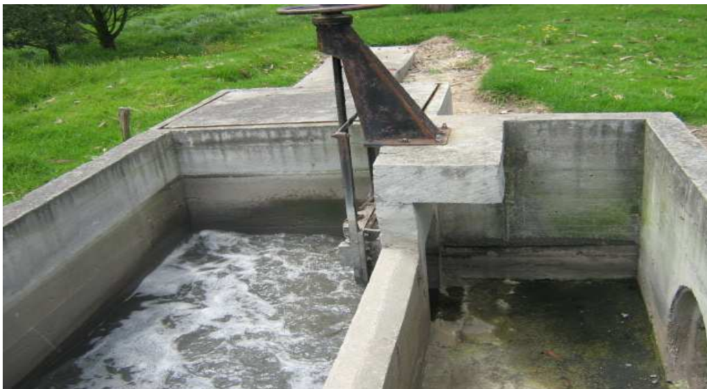
Foto 2. Rejilla de Cribado
