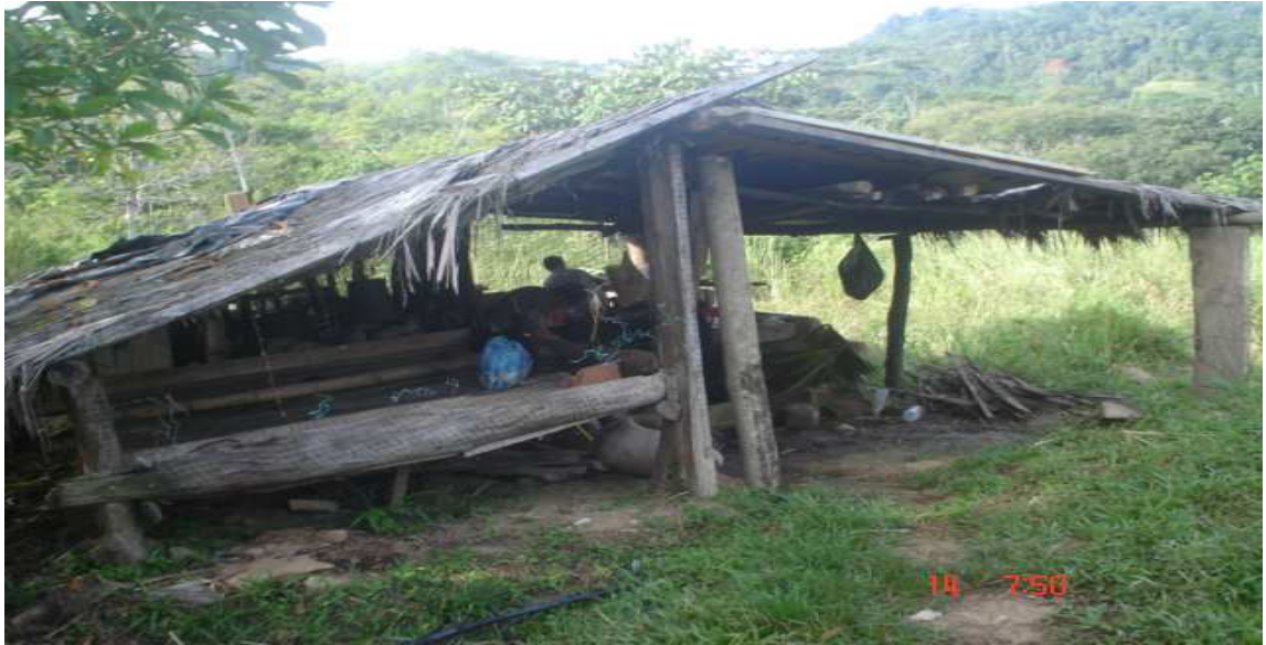
FIGURA 4. Establo en estado de deterioro al comenzar el proyecto
