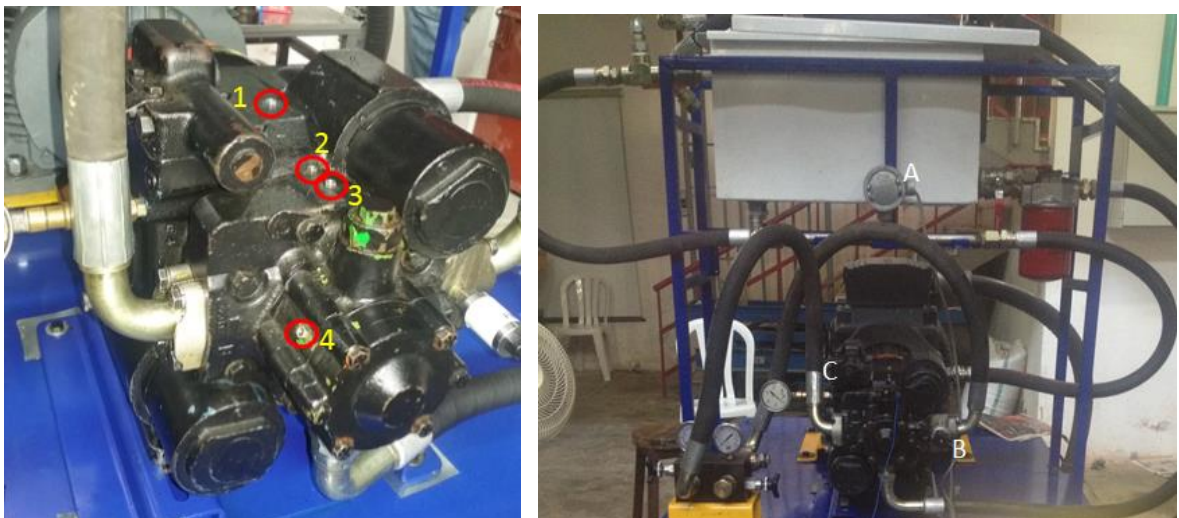
Figura 24. Puntos de medición de vibraciones en la bomba
