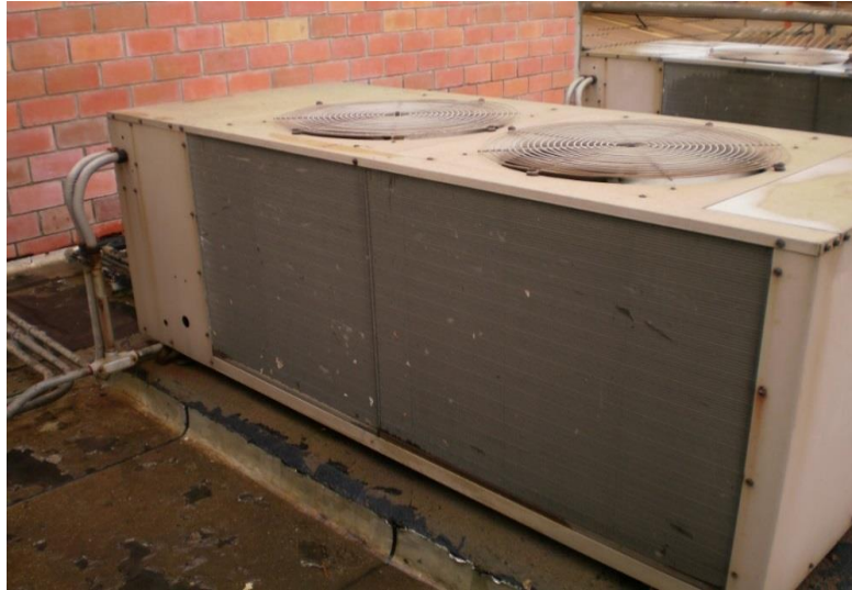
Figura 12. Condensadora de un sistema Split condensado por aire
