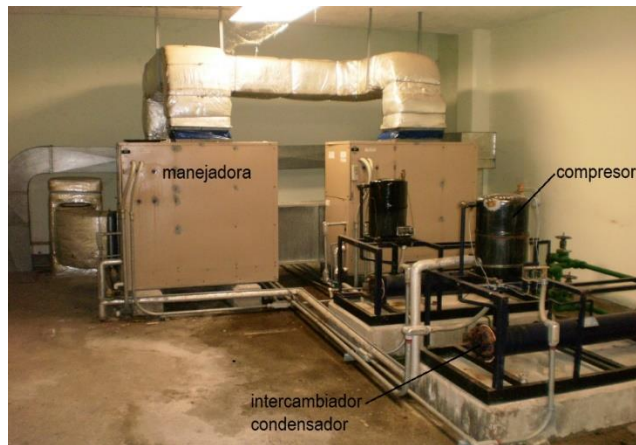
Figura 11. Sistema Split condensado por agua
