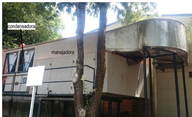
Figura 13. Equipo paquete condensado por aire
