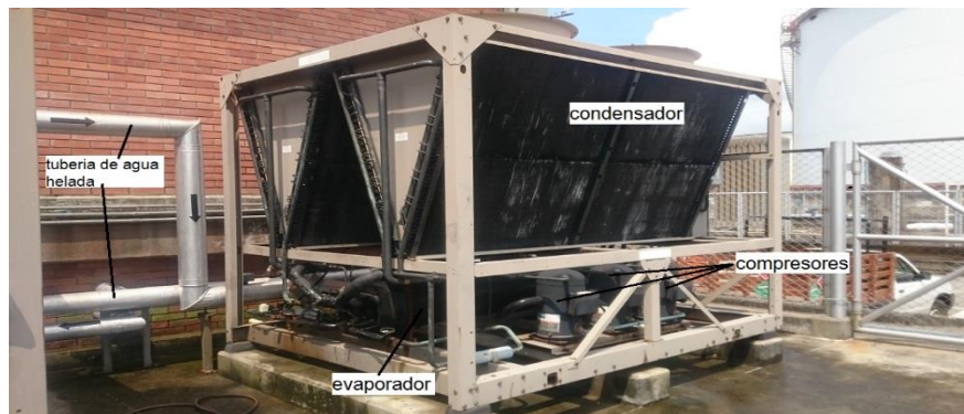
Figura 18. Chiller condensado por aire
