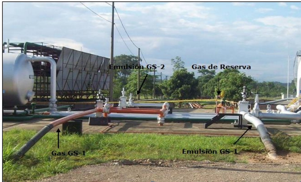
Figura 10. Estación principal. ECOPETROL S.A. (2010). Estación principal. Adaptado de Manual de operaciones y procedimientos de la estación principal”, Exploración y producción
