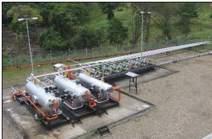
Figura 8. Estación de tratamiento GS2. Adaptado de ECOPETROL S.A. (2010). Manual de operaciones de La Estación GS1”, Exploración y producción
