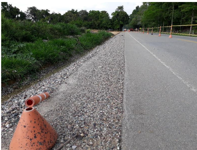
Figura 1 Señalización deteriorada sobre la vía
