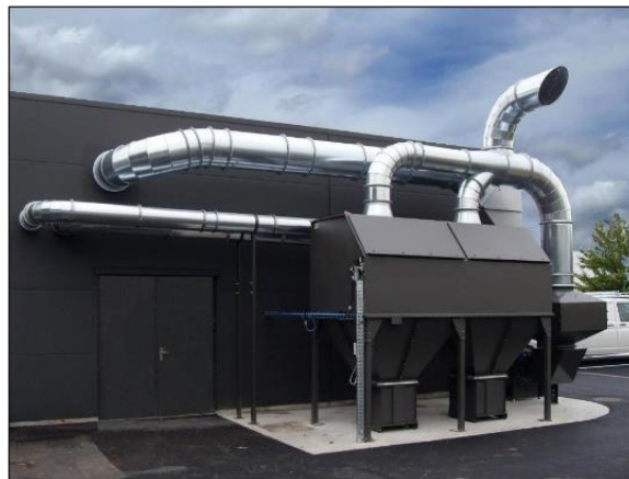
Figura 7. Ductos de extracción y transporte de gases
