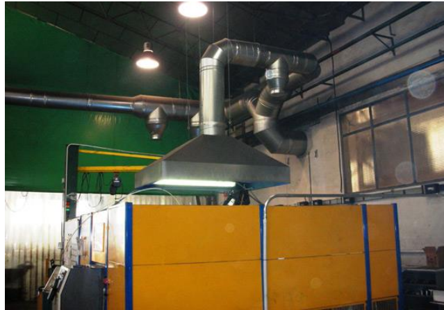
Figura 4. Campana de extracción de humos de soldadura
