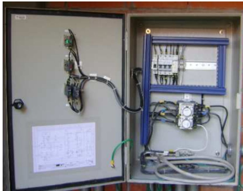
Figura 31. Transferencia Automática ATS
