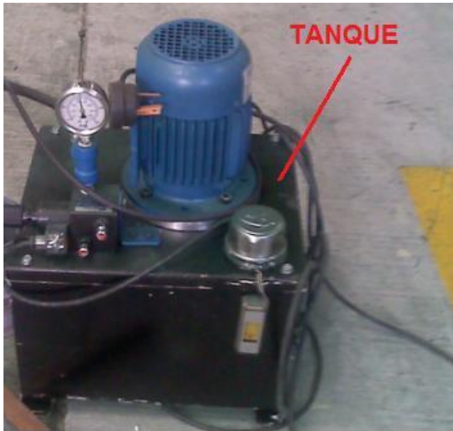
Figura 6. Tanque unidad hidráulica
