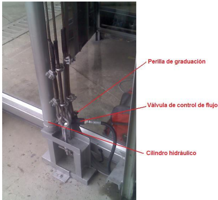
Figura 14. Válvula de control de flujo
