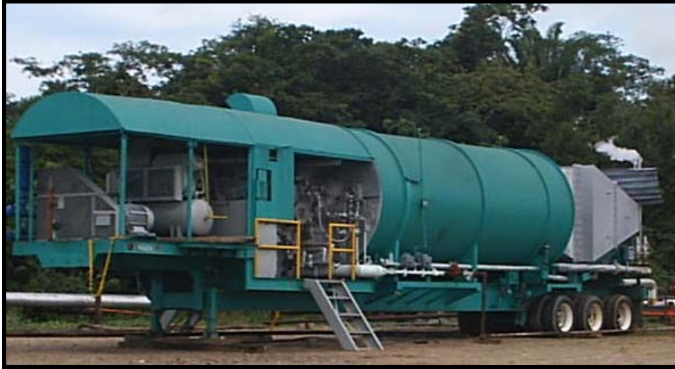
Figura 22. Generador de vapor móvil con llantas
