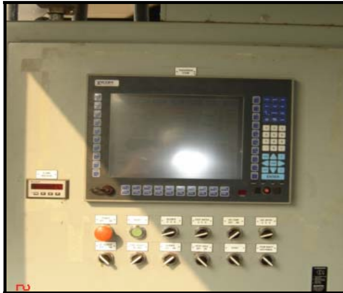
Figura 24. Panel de control del generador
