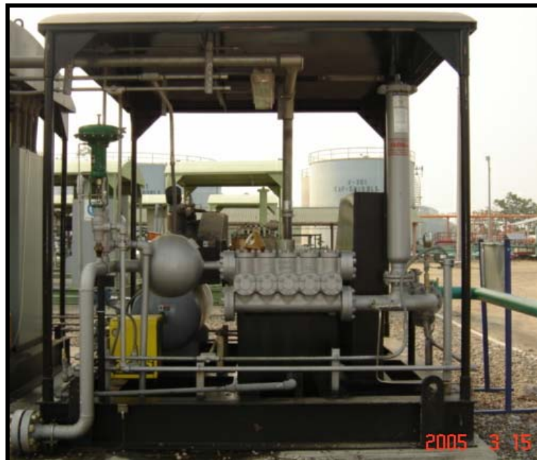
Figura 25. Bomba para agua de alimentación al generador
