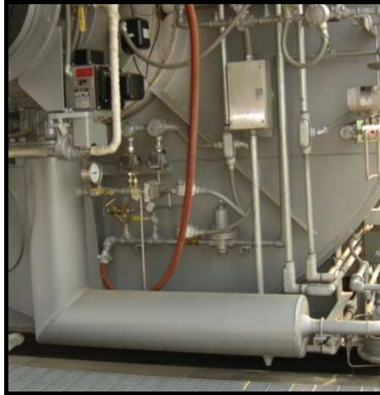
Figura 30. Sistema de combustible del generador
