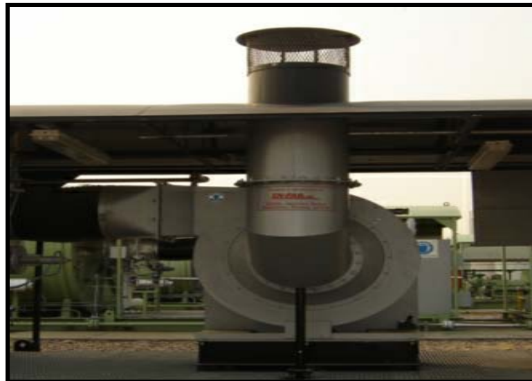
Figura 29. Quemador del generador
