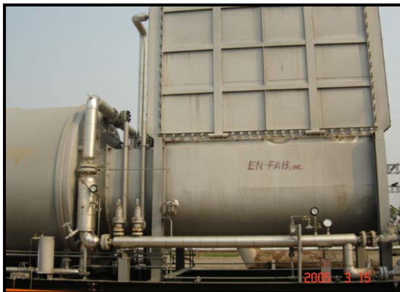
Figura 27. Serpentin de la zona de convección del generador
