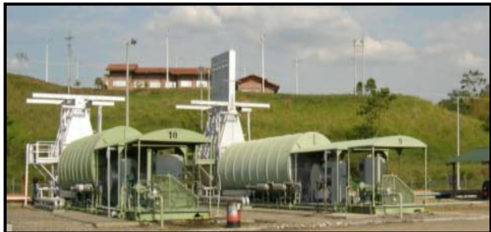
Figura 21. Generadores de vapor estáticos
