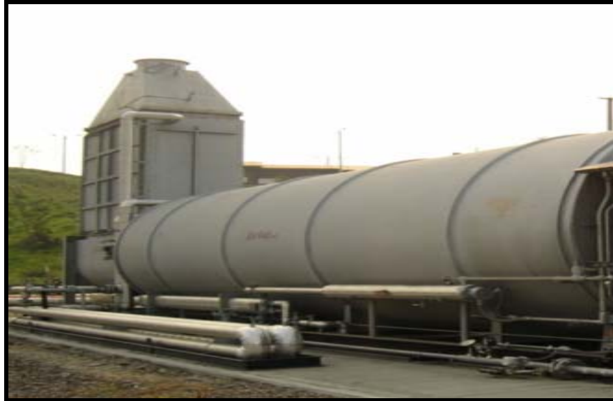
Figura 26. Calentador para agua de alimentación al generador
