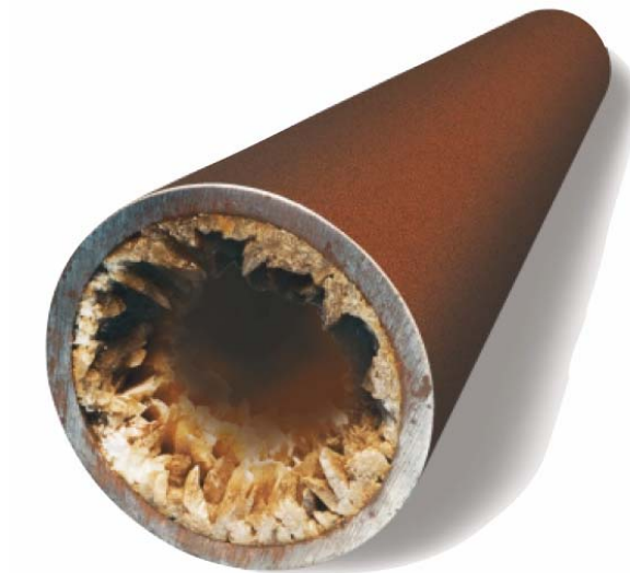
Figura 31. Incrustación en la tubería de producción
