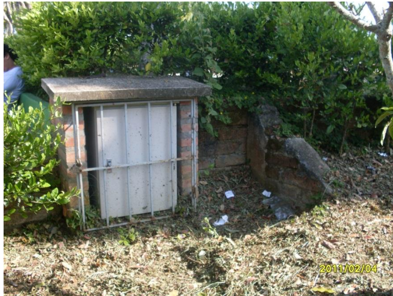
Ilustración 31 Ubicación tablero de distribución
