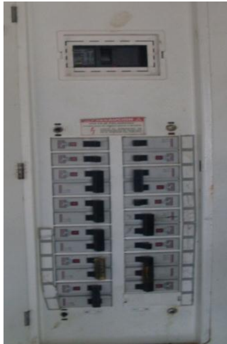
Ilustración 37 Tablero de distribución
