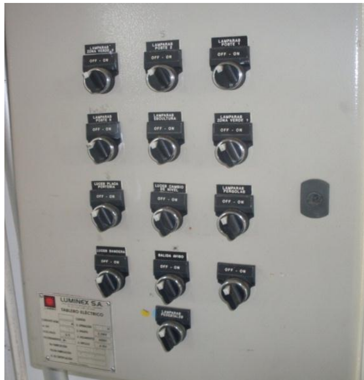
Ilustración 36 Tablero electrónico de distribución
