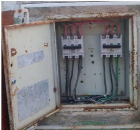
Ilustración 35 Interruptores termomagnéticos QCX-3040
