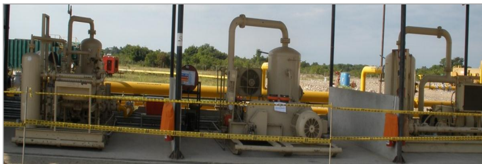
Figura 22. Unidades Recuperadoras de Vapor
