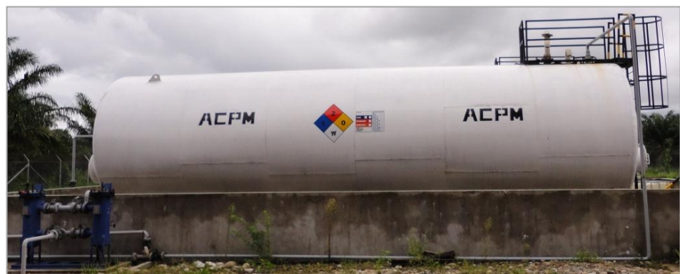
Figura 9. Tanque de 500 Bbl para el almacenamiento de Diesel
