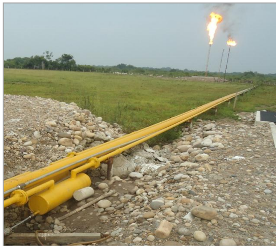
Figura 23. Recolectores de condensado y Tea de alta de 4,5
