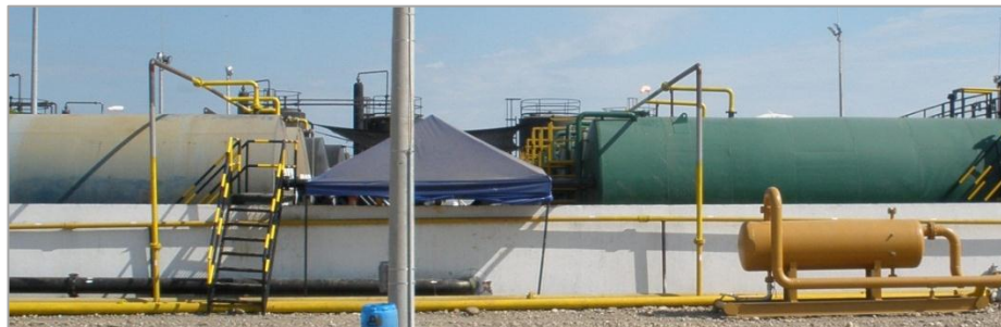
Figura 25. Líneas de recolección de gas de tanques y Knock Out Drum para gas de Baja
