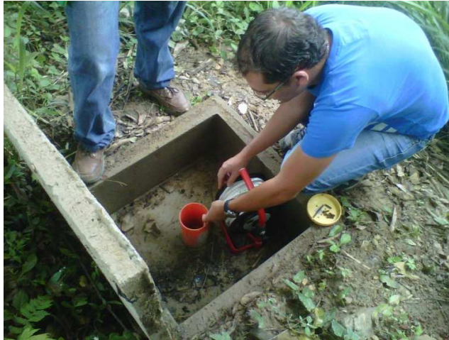
Figura 7. Detalle Cajas y boca de los piezómetros Pan de Azúcar
