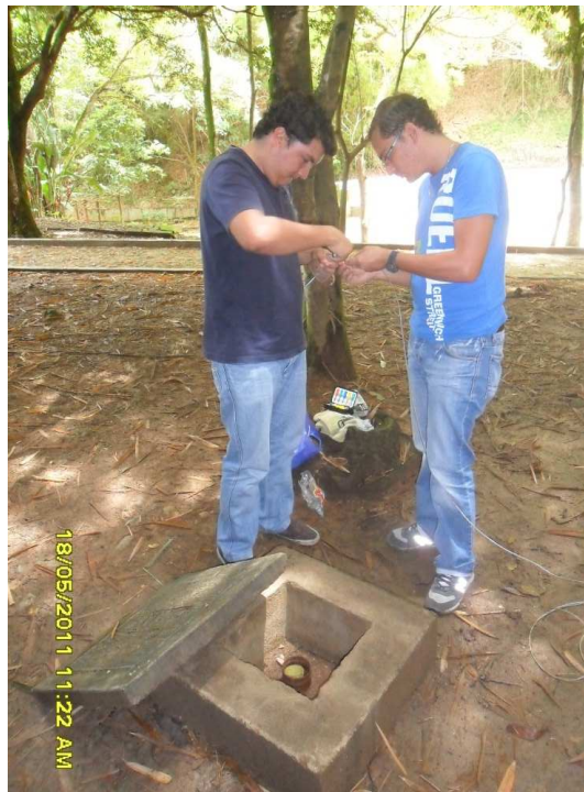
Figura 6. Cajas de seguridad y sistema de suspensión de los equipos en los piezómetros del Parque La Flora
