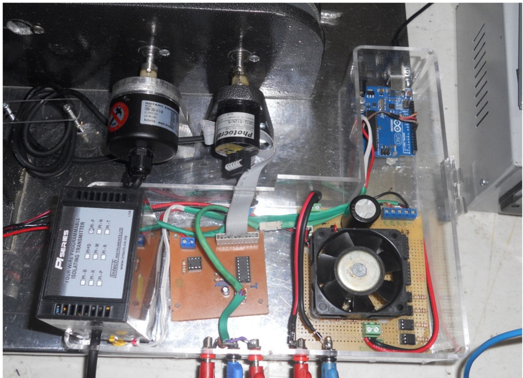
Figura 25. Dispositivo de control electro-electrónico.
