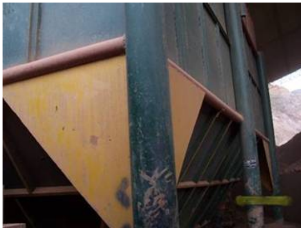
Figura 12. Silo de almacenamiento
