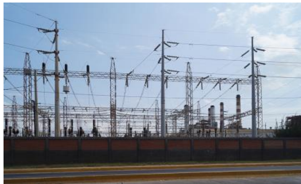
Figura 24. Líneas de transmisión de energía eléctrica
