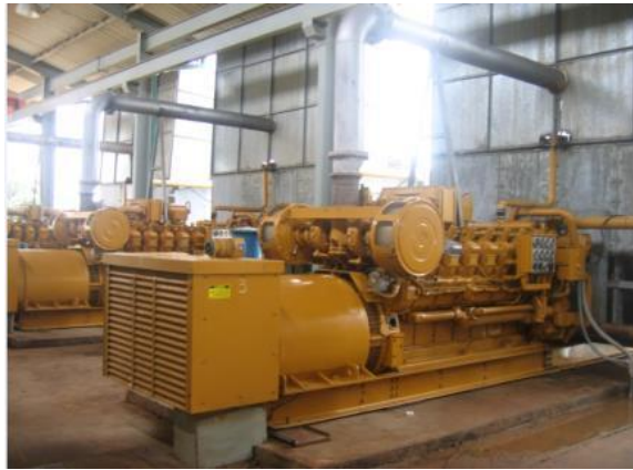
Figura 23. Generador eléctrico con motor a gas
