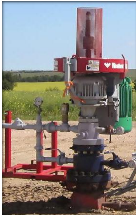
Figura 5. Unidad Progressive Cavity Pump (PCP)
