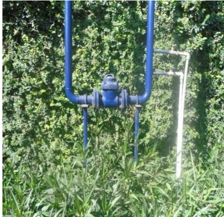
Foto 1. Alimentador del acueducto
