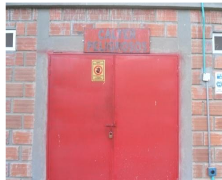
Foto 10. CALTER de residuos peligrosos
