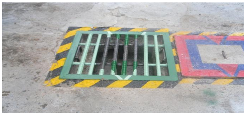
Foto 8. Alcantarillado de aguas lluvias
