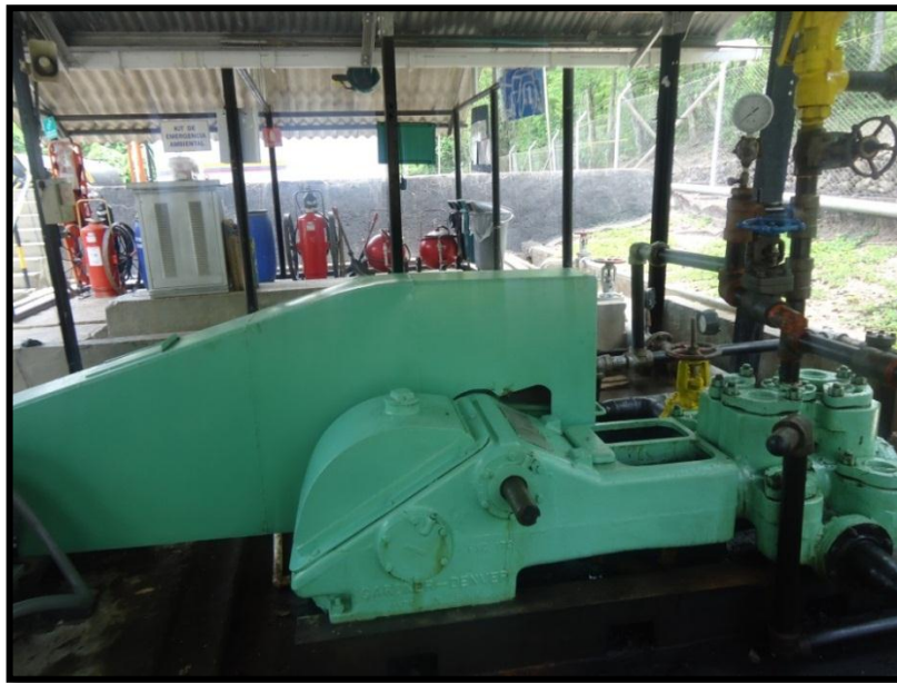
Figura 12 Bomba de Transferencia
