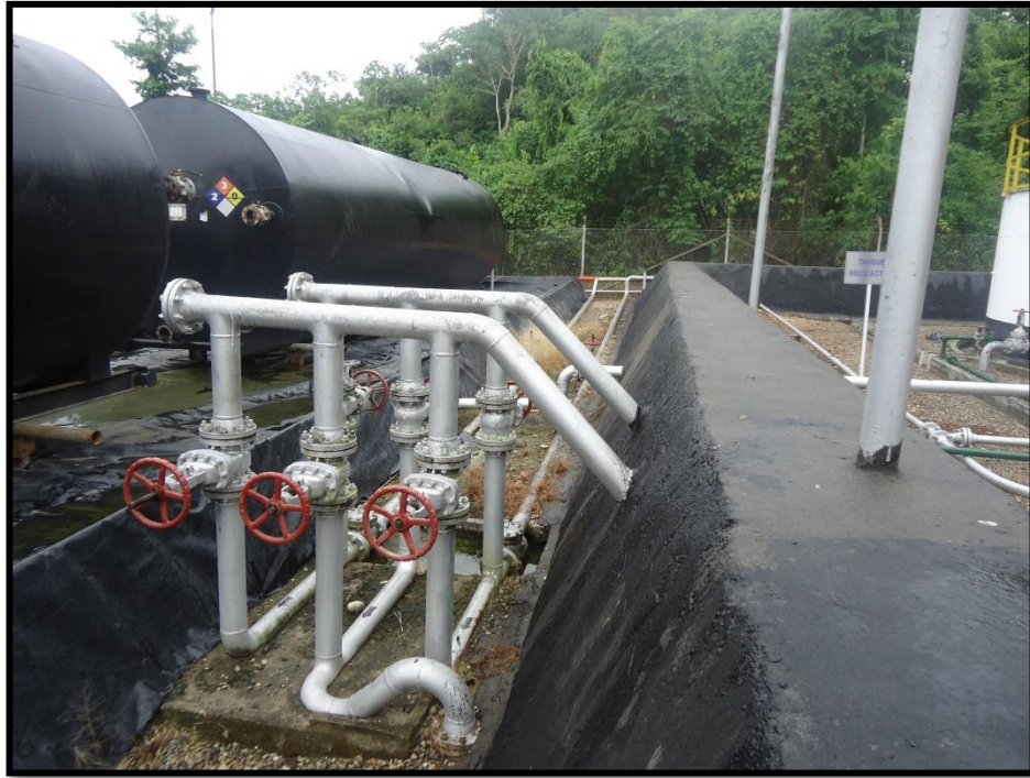
Figura 4 Múltiple de Entrada
