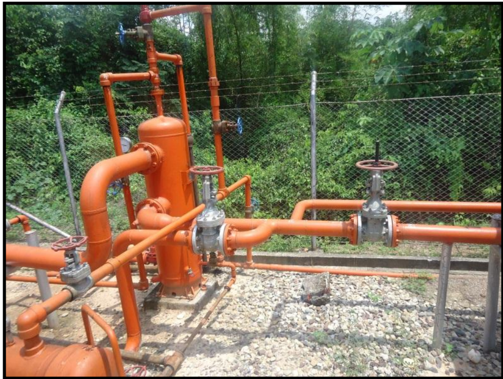
Figura 15 Depurador o Scrubber
