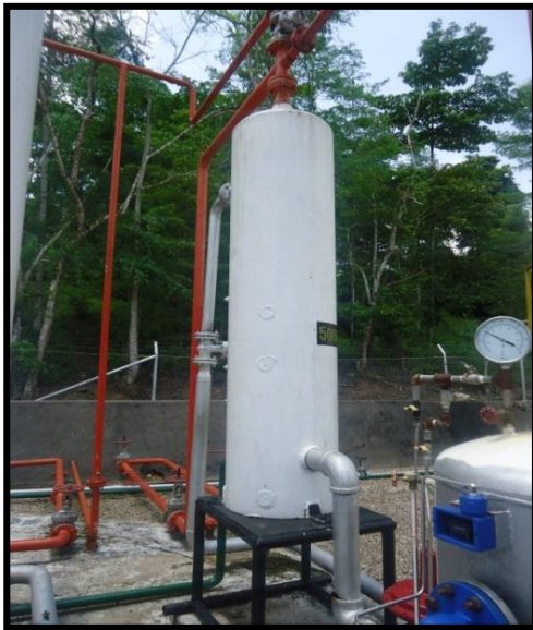
Figura 5 Separador de Prueba
