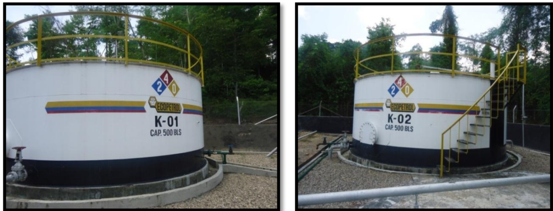
Figura 10 Tanques de Almacenamiento
