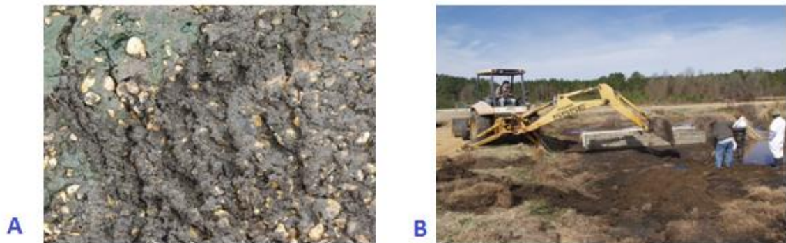
Figura 28. A, lecho granular colmatado; B, extracción de un lecho colmatado. Aliceville, USA.
