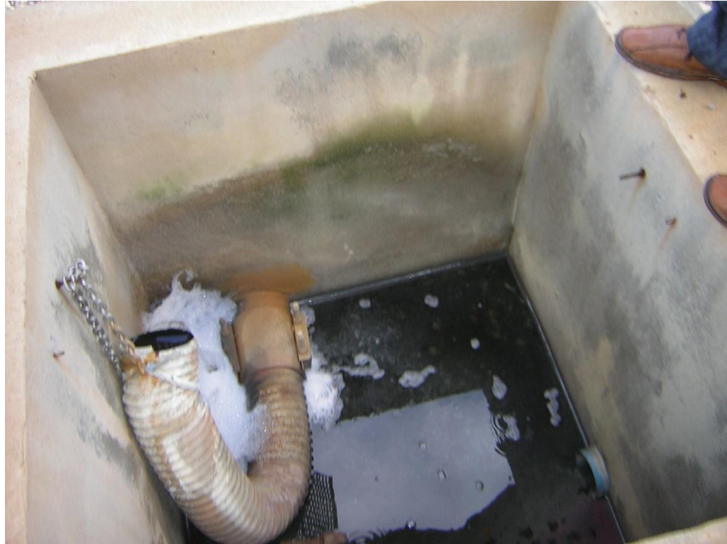
Figura 11. Unidad de control de nivel de agua en un HCFSSH en Almatret Nord, Cataluña.
