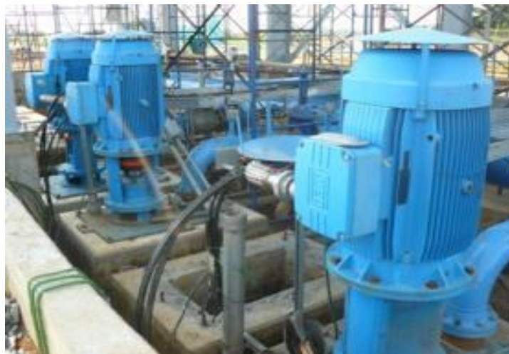
Figura 22. Bombas de vertimiento campo. 132.000 BLS/Prom. CU
