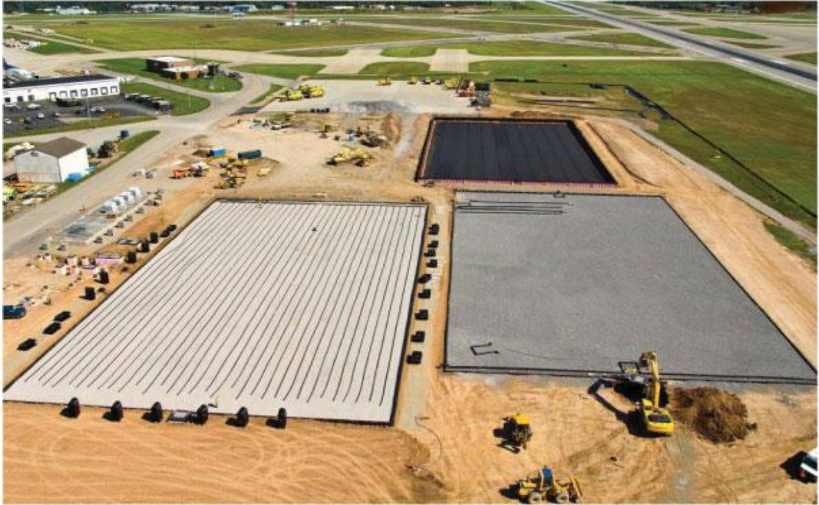
Figura 9. HCFSSV para tratar agua de producción, en etapa de construcción en Buffalo, Nueva York, USA.
