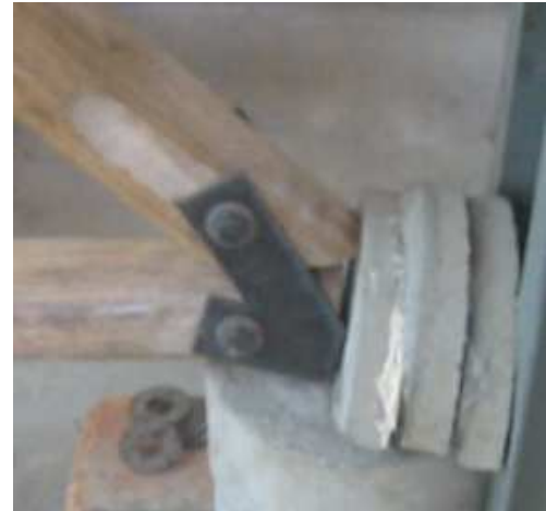
Figura 78. Modo de falla del nodo C de la cercha triangular
