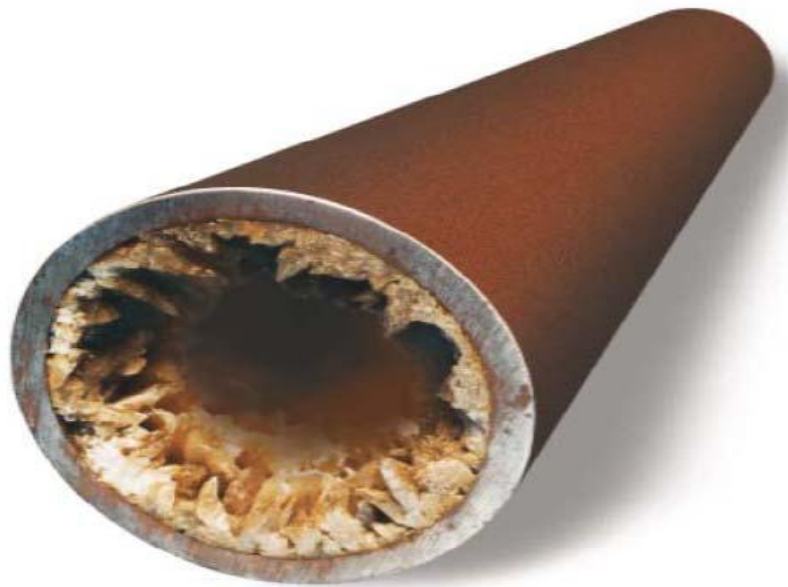
Figura 1. Formación de incrustaciones dentro de la tubería.
