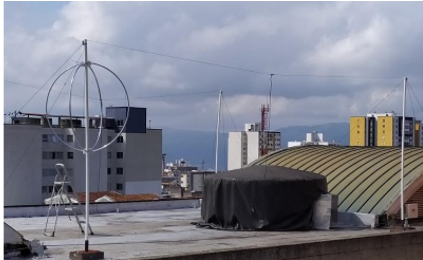
Figura 33: Antena SALLA instalada.
