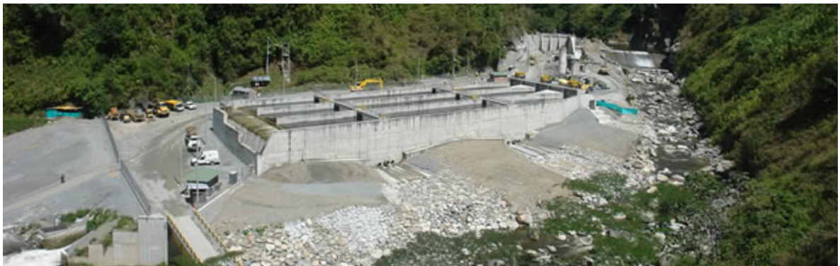
Figura 6: Proyecto Hidroeléctrico Amoyá
