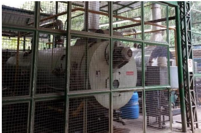
Figura 2. Calderas de 150 BHP - Planta de beneficio.
