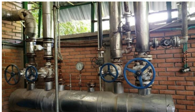
Figura 12. Distribuidor principal de vapor - Planta de beneficio.
