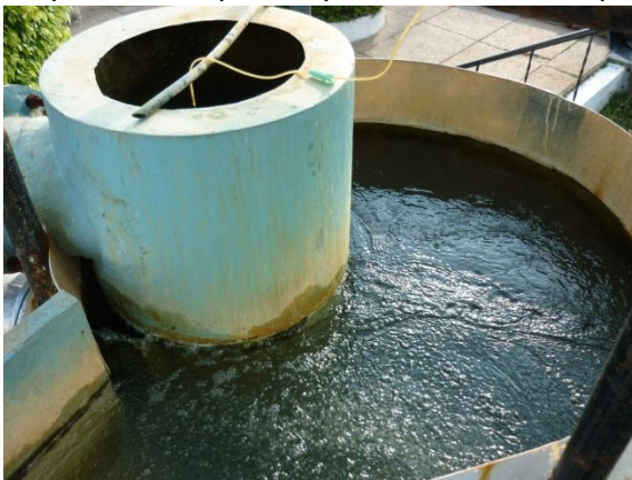
Imagen 1. Tanque de mezclado del Coagulante
