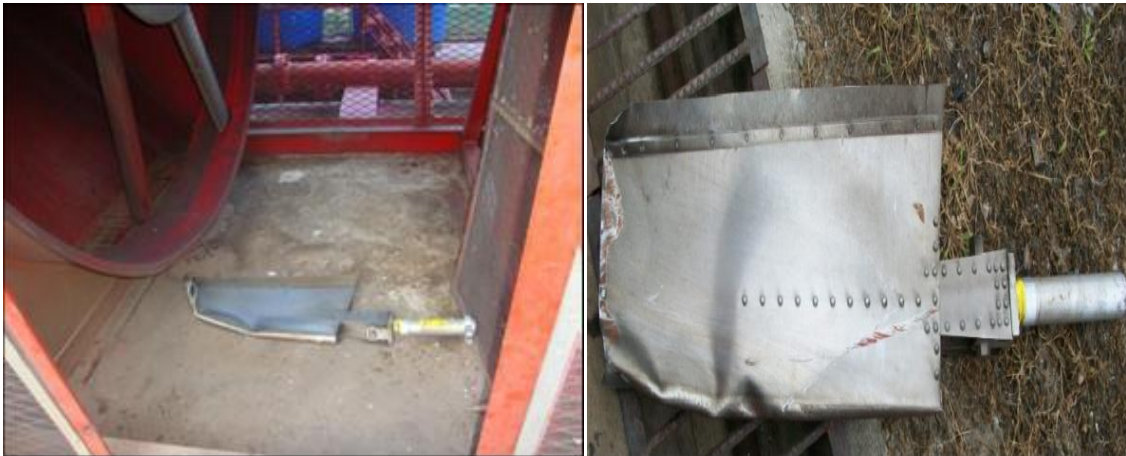
Figura 18. Aspa de Ventilador Partidas – Compresor 17LP. Estación Suerte
