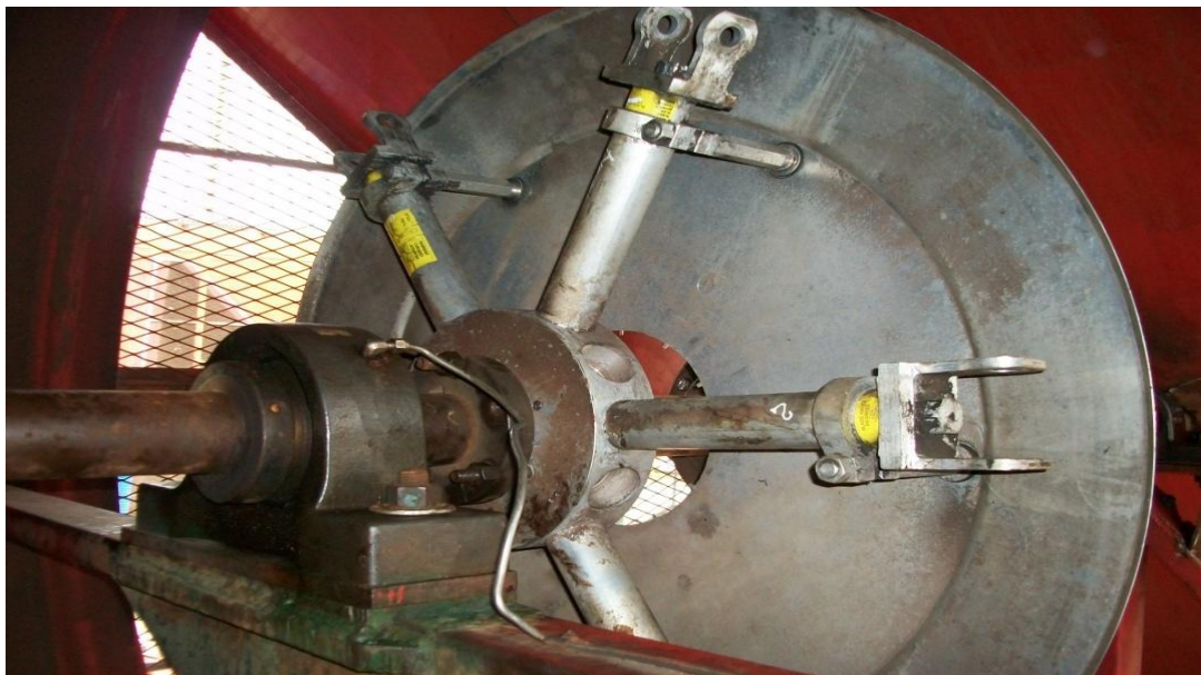
Figura 19. Ventilador sin aspas de una Máquina Compresora.
